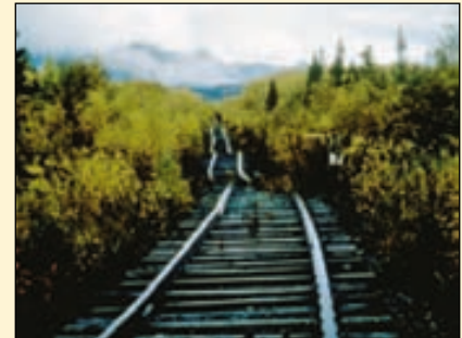
▲ Figura 15.G Cuando se construyó el ferrocarril a través de este paisaje de permafrost en Alaska, el suelo experimentó subsidencia. (Foto de Lynn A. Yehle, U. S. Geological Survey.)
